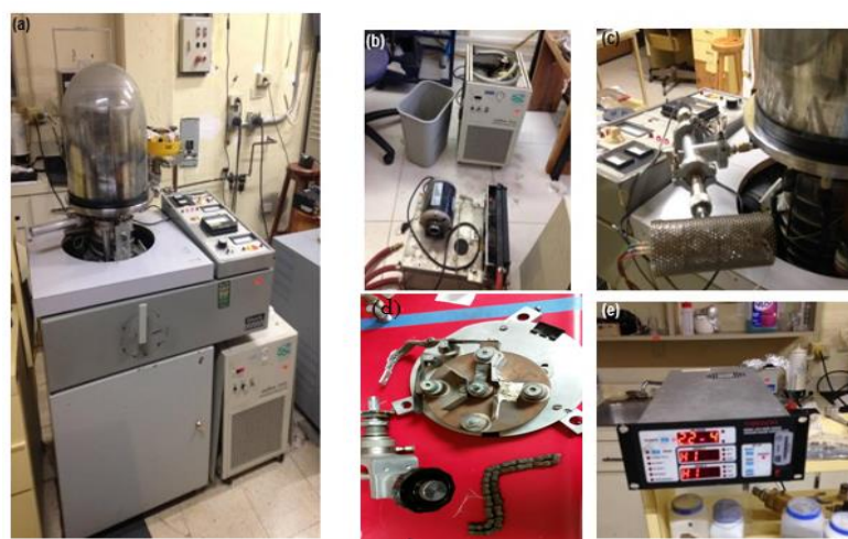
Figura 16. (a) Evaporadora Edwards E306, (b) Mantenimiento al enfriador, (c) Vacuómetro de ionización de filamento caliente, (d) carrusel de botes, (e) Controlador terranova.
