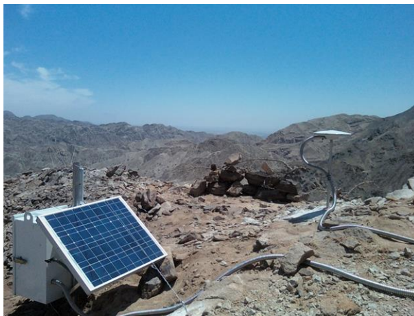
Figura 8. Estación GPS de monitoreo continuo en Cañada David Este (DAEX). Vista hacia el Valle de Mexicali.
