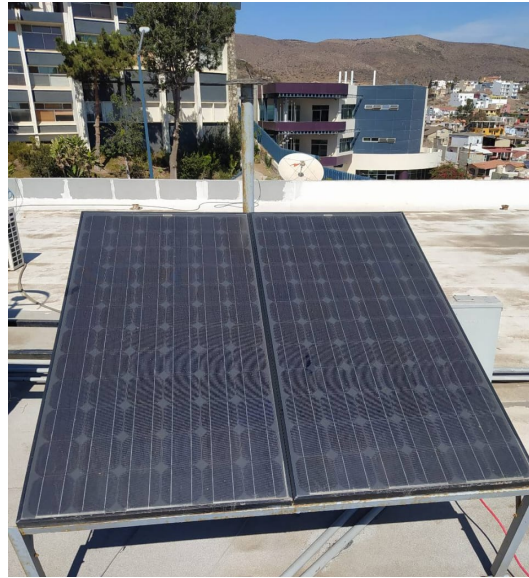
Figura 23. Panel fotovoltaico de la marca SunTech.
